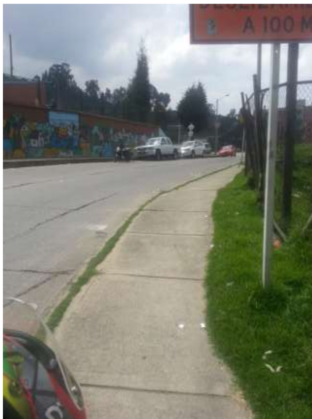
Fotografía 2. Estado de la avenida carrera 18 Este, objeto de intervención por parte de IDU. Sector en el cual se plantea la adecuación de la cuneta.
